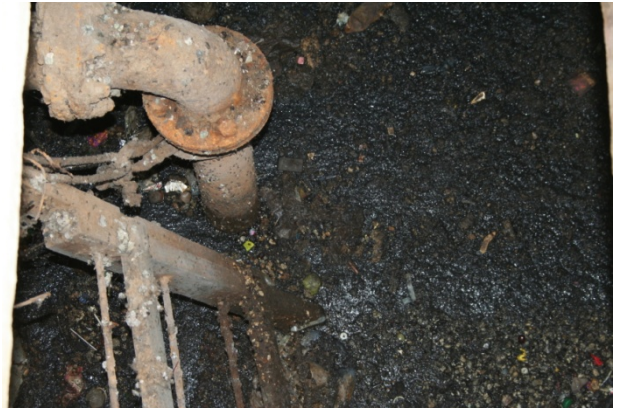
Foto 2 – Poço de Sucção da Elevatória
